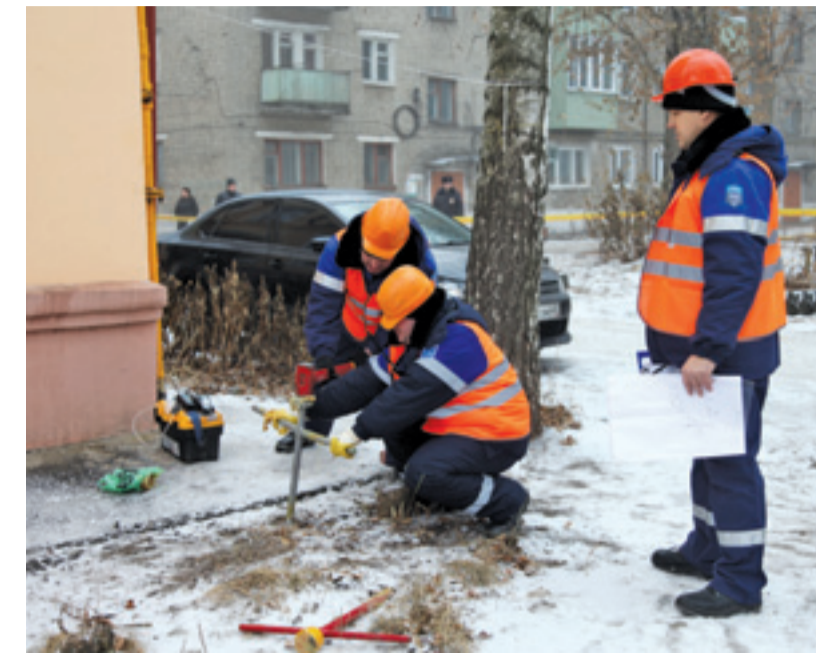
С помощью бурения шурфов вдоль линии газопровода обнаружили место повреждения
