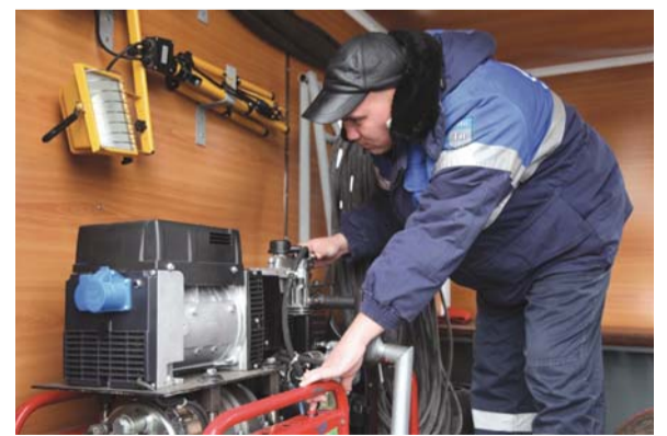
Сергей Меркин запускает станцию электропитания
