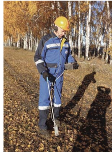
Монтер 5-го разряда службы электрохимической защиты (СЭХЗ) ПТУ Михаил Юдаев выявляет нарушения изоляционного покрытия на подземном газопроводе высокого давления к совхозу «Авангард» с помощью прибора АНПИ
