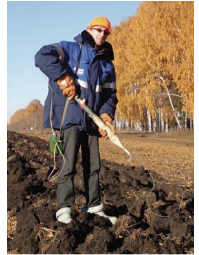
Слесарь 4-го разряда подземных газопроводов СЭХЗ Андрей Куприянов производит обследование целостности изолирующего покрытия подземного газопровода высокого давления к ст. Селezni после выполнения ремонтных работ на газопроводе с помощью прибора ДКИ
