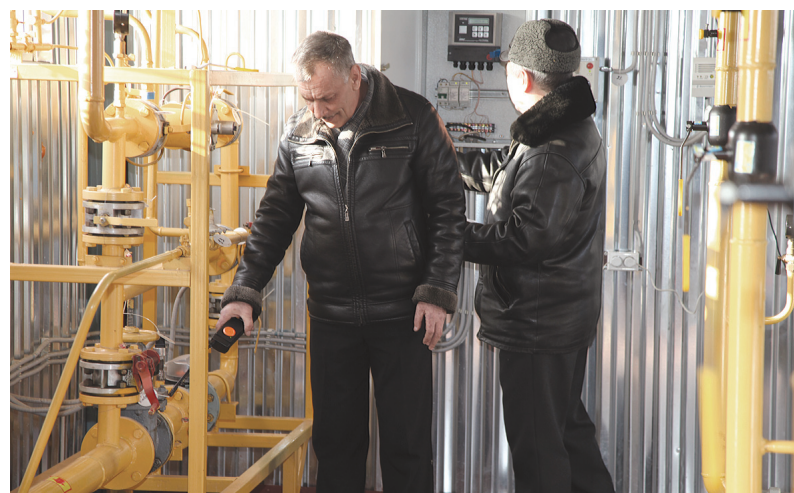
Инженер КИПиА ЦДС ОАО «Тамбовоблгаз» Владимир Амелин и ведущий инженер-метролог отдела метрологии ООО «Газпром межрегионгаз Тамбов» Олег Абрамов проводят проверку герметичности фланцевых соединений в котельной ООО «Модульные котельные-Н» в мкр. Радужном
