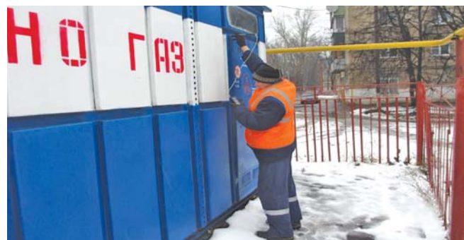
Слесарь АДС филиала АО «Газпром газораспределение Тамбов» в п. Коммунар Владимир Деянов проверяет на загазованность ГРП
