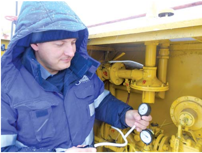
«НАСТРОЙКА ПРЕДОХРАНИТЕЛЬНОЙ АРМАТУРЫ ПУНКТА РЕДУЦИРОВАНИЯ ГАЗА (ПРГ) БЕЗ ИСПОЛЬЗОВАНИЯ ПРИРОДНОГО ГАЗА И СБРОСА В АТМОСФЕРУ»
